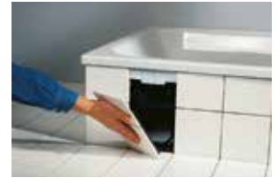
Die Trägerplatte in den Fliesenrahmen einsetzen und die gesamte Fläche wie üblich verfugen.
